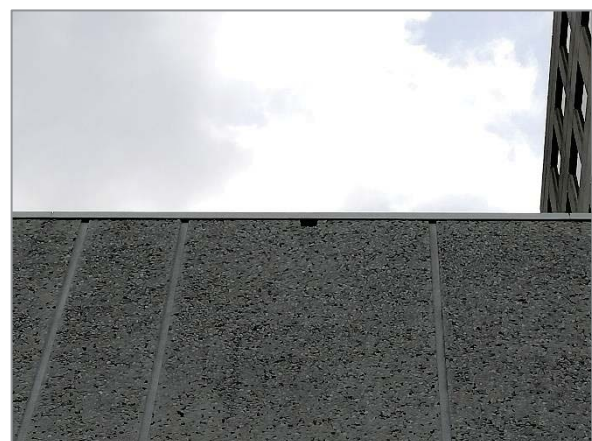
Afbeelding 5.3 | Gat bij dakrand rechts boven hoofdingang
