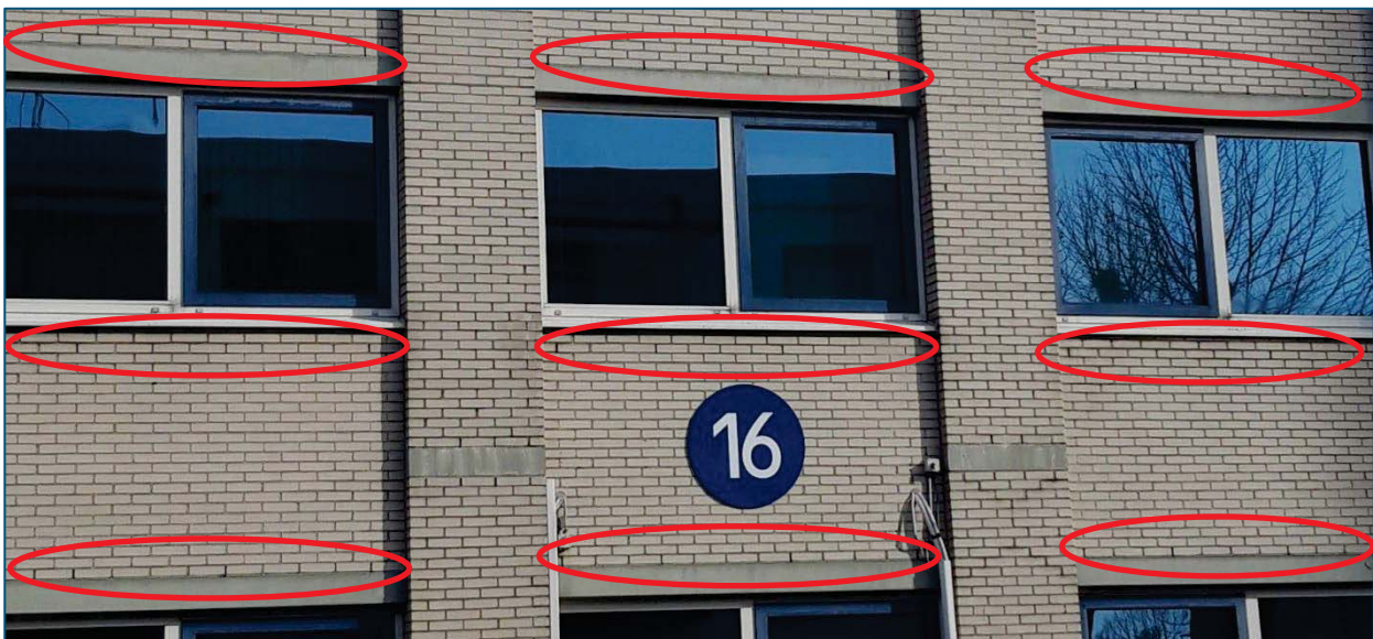
Figuur 7-18 Locaties van de open stootvoegen in het gebouw aan de Planetenbaan 16, welke mogelijk toegang geven tot geschikte verblijfplaatsen voor vleermuizen. In gebouw aan de Planetenbaan 15 bevinden de open stootvoegen zich op dezelfde plekken (foto: RHDHV, 2021)
