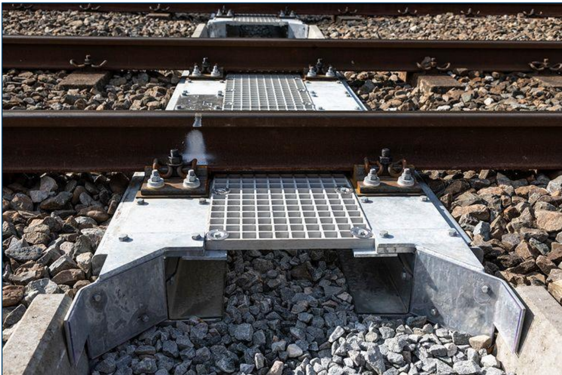
Figuur 4.3: Voorbeeld van een dwarsligger faunapassage voor amfibieën en reptielen. Uit onderzoek blijkt dat dassen ook gebruik maken van deze passage (al is deze naar verwachting minder geschikt dan de 'standaard' passage die voor das gebruikt wordt).
