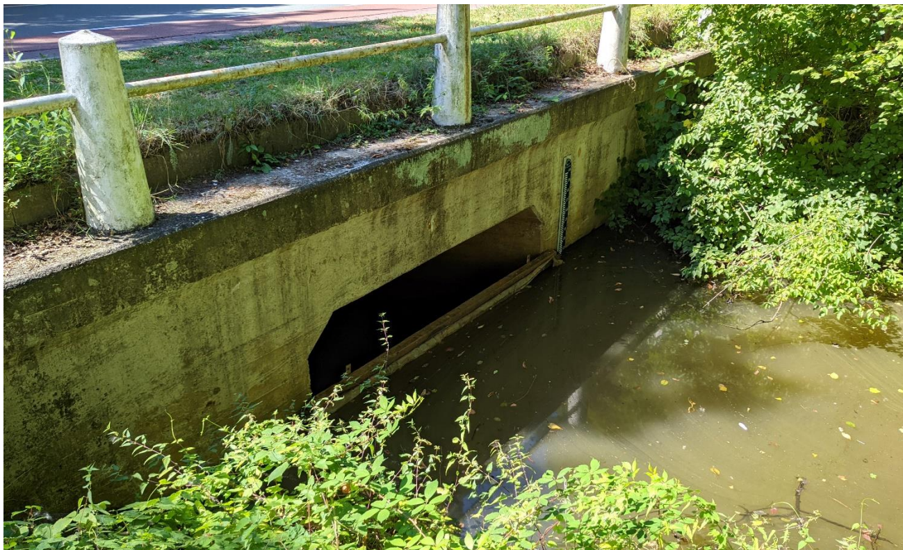
Figuur 24. Schotbalkstuw bij de duiker onder de Schans.
