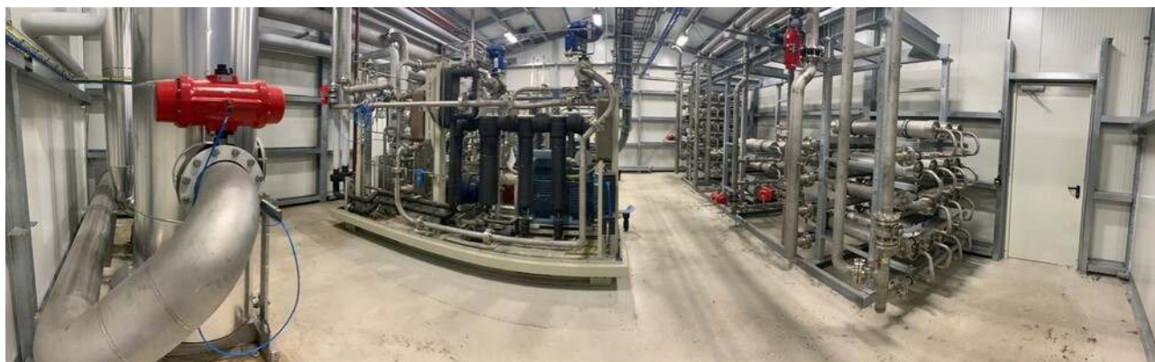
Figuur 10 opwaardeerinstallatie (gas compressor module midden en membraanrekken rechts) bron www.biogasplus.nl
