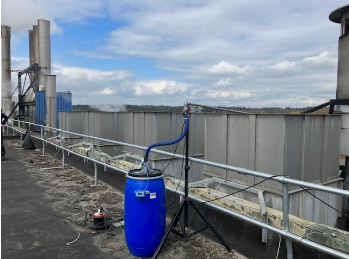
Foto 1i: Meetvlak bron 4 - afzuiging halventilatie natpartij d.d. 18-04-2023.
