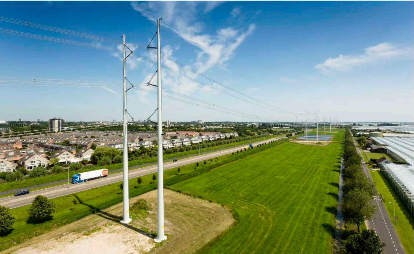
De Wintrackmasten hebben een modernere uitstraling dan de traditionele vakwerkmast en hebben ze de eigenschap het landschap te doorsnijden Bron: https://www.zja.nl/nl/Wintrack-masten
