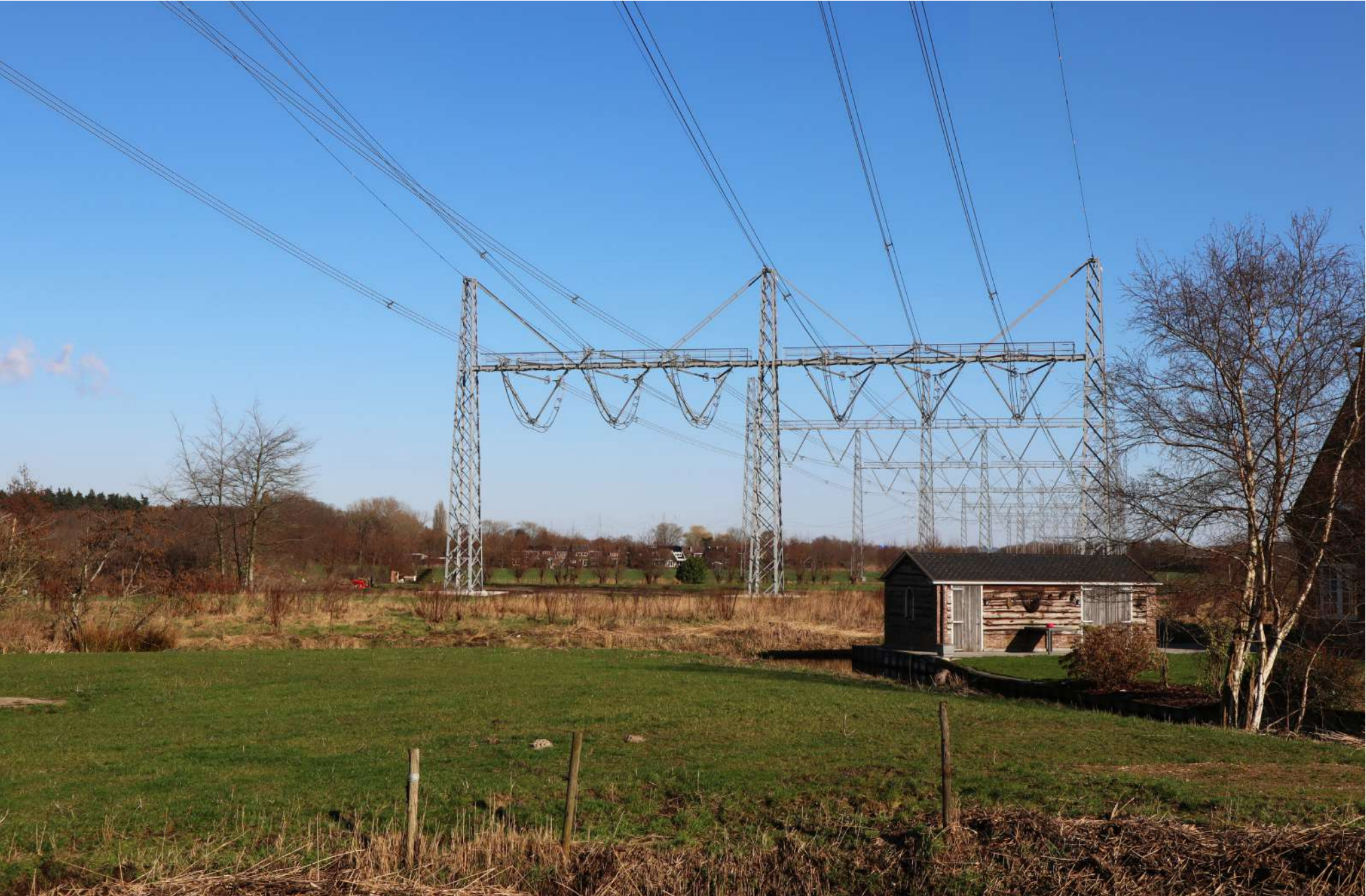
Een deel van het bestaande 380 kV hoogspanningstracé tussen Diemen en Ens bestaat uit portaalmasten. Dit masttype heeft lagere hoogte maar een breder ruimtebeslag
