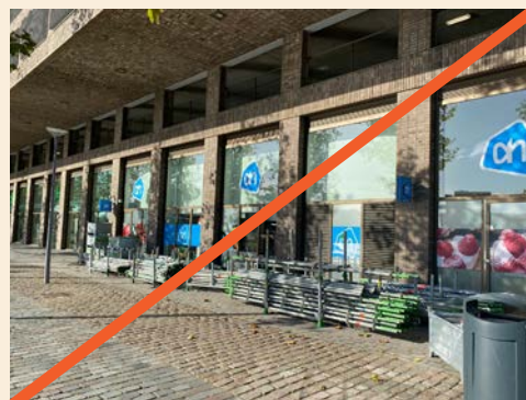
3.66 GEEN open geveldelen met afgeplakte reclame
