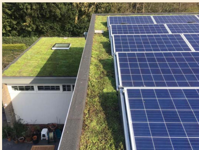
5.12 Zonnepanelen op groen dak achter daklijst
