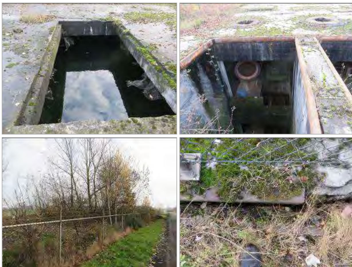
Afbeelding 1. De betreffende kelders. Van linksboven naar rechtsonder: de volgelopen kleine kelder, de grote kelder, het omheinde terrein en toegang tot de kelder van buitenaf. Foto's: J. Rijdsdijk, 2014.
