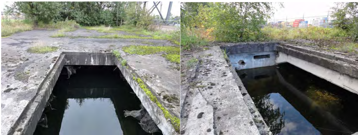
Figuur 3.2. Kelder 1 (links) en kelder 3 zijn beide grotendeels gevuld met water.
