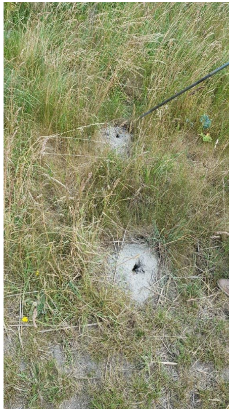
Figuur 59 Onderzoek naar de bekleding op het binnentalud (links) en ontbreken van de grasbekleding bij dijkpaal 89.8 (rechts)
