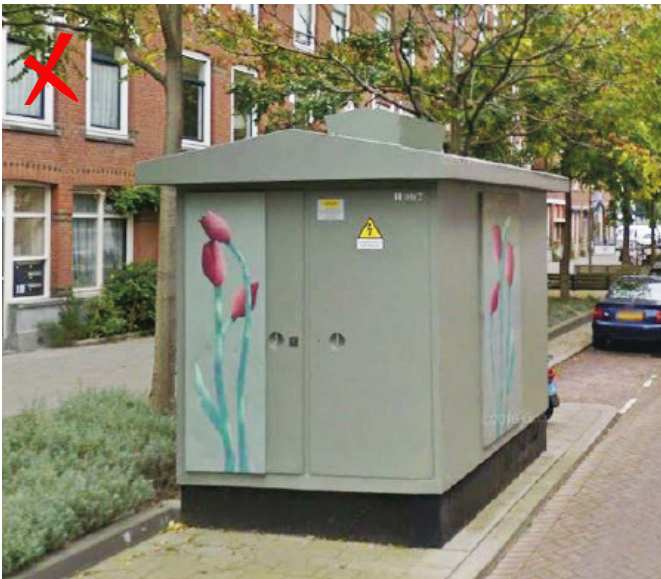
Installaties in de openbare ruimte.
