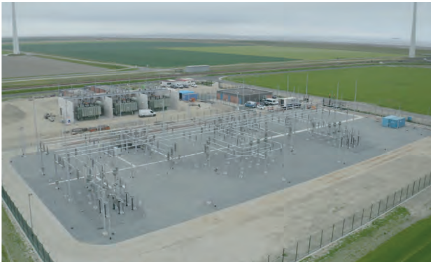
Voorbeeld van een middenspanningsstation (Eemshaven, bron: Tennet) 1
