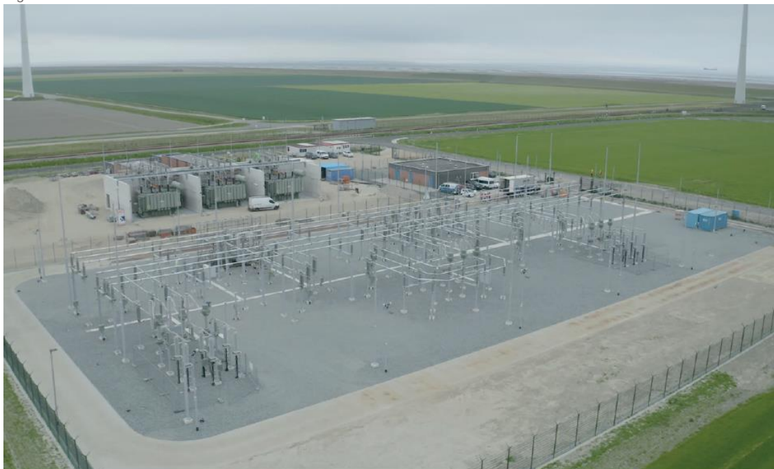
Figuur 2.3 Voorbeeld HS-station
