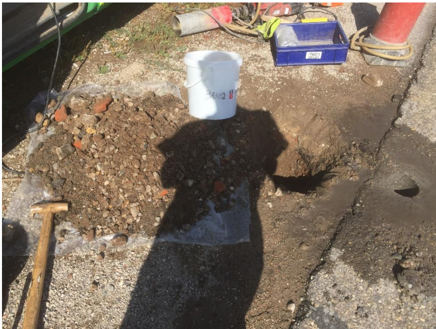
Foto 10: asbestgat BAS02 tracé Bokhoven
