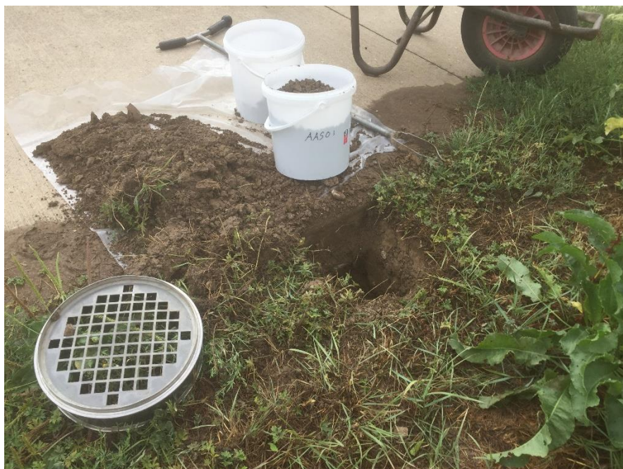
Foto 3: asbestgat AAS01 op het tracé Ammerzoden
