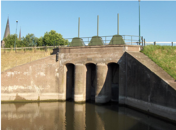
Figuur 9-1 Constructie Inlaat Kromme Rijn (bovenhoofd)
