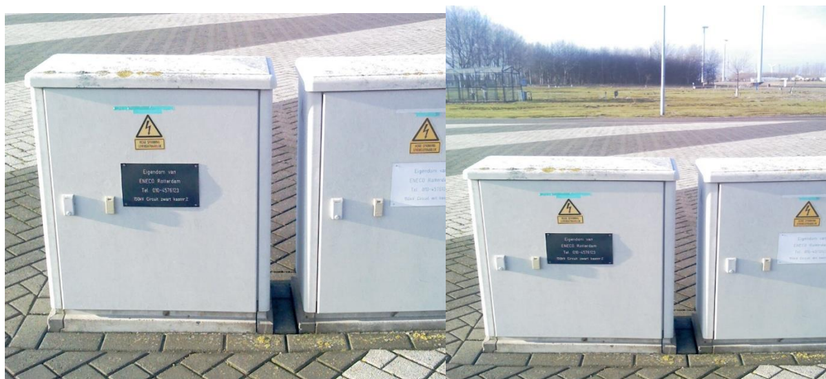
Figuur 6.8 Ten behoeve van het monitoren van de conditie van de kabels worden cross-bonding kasten gerealiseerd
