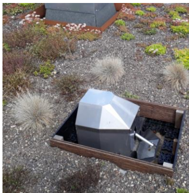
'Slim' waterbergend dak, Zuidas, Amsterdam
