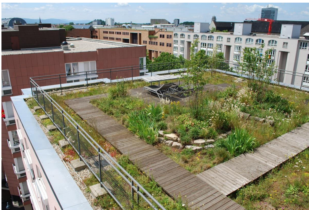
Figuur 41. Een voorbeeld natuurdak met schrale kruidenrijke begroeiing verminderd hittestress, werkt isolerend, fungeert als waterbuffer, heeft een hoge biodiversiteit, vergroot de waarde van het gebouw en kan bovenal een lust voor het oog zijn. Bron: http://www.optigroen.nl/ontwerphulp/valgevaar/biodiversiteit-natuurdak/ .
