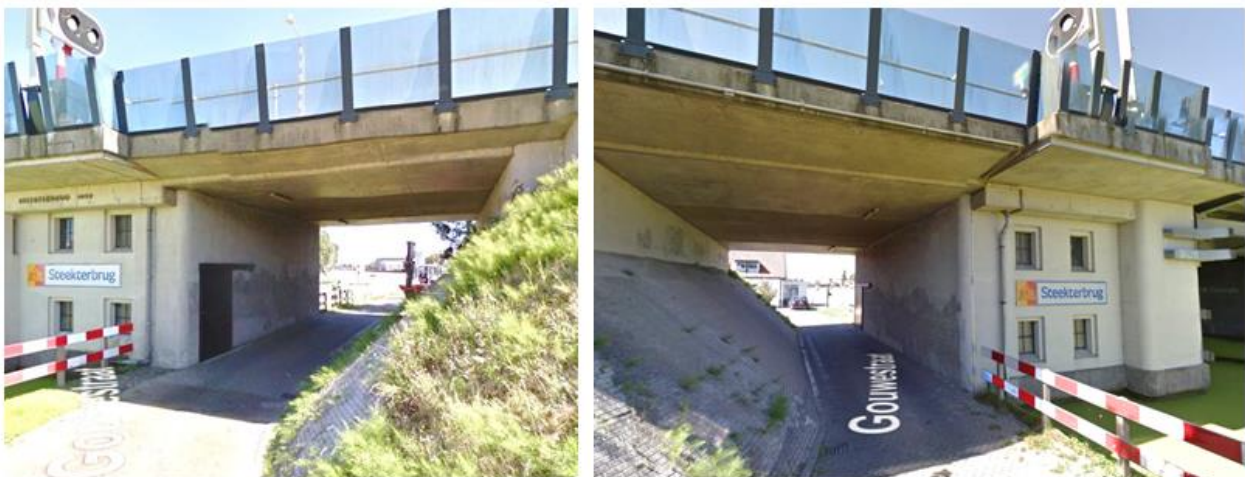
Figuur 7-2: huidige onderdoorgang zuidzijde Oude Rijn (links: zijde Gouwekade; rechts: zijde Gouwestraat).
