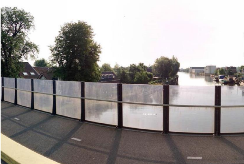
Figuur 8-2: geluidsscherm op de Steekterbrug.
