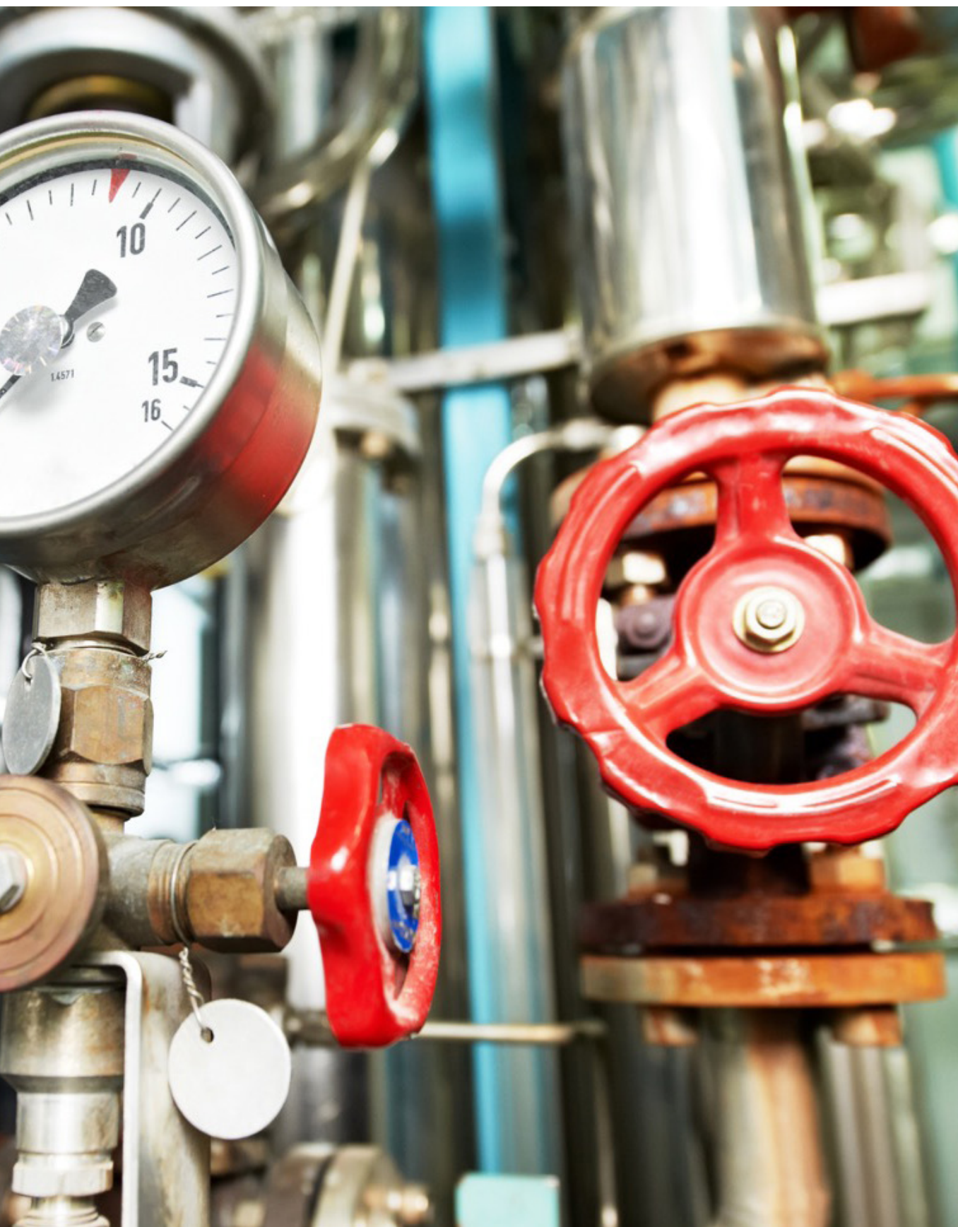
25. Detail van een warmteinstallatie ( armisteadmechanical.com )
