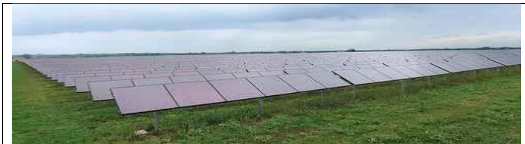
Figuur 5. Voorbeeld van zonne-energie park (bron: www.duurzameenergiethuis.nl )
