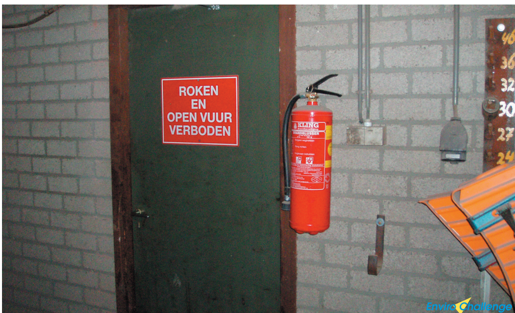
Illustratie 2 : Verbod op roken en open vuur bij olieopslagplaats
