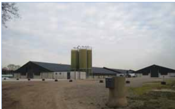
Het nieuwe erf aan de Grensweg in aanbouw, de lichte zijgevels vallen op in het landschap
