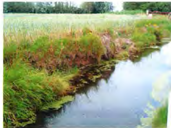
Afbeelding 13: Afkalving sloottalud Zuiddijk
