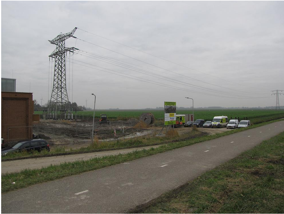
Figuur 18 Eindstation voor het kabeltracé.
