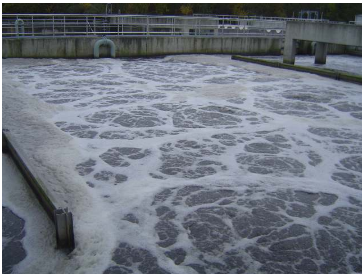
Beluchtingstank open gedeelte
