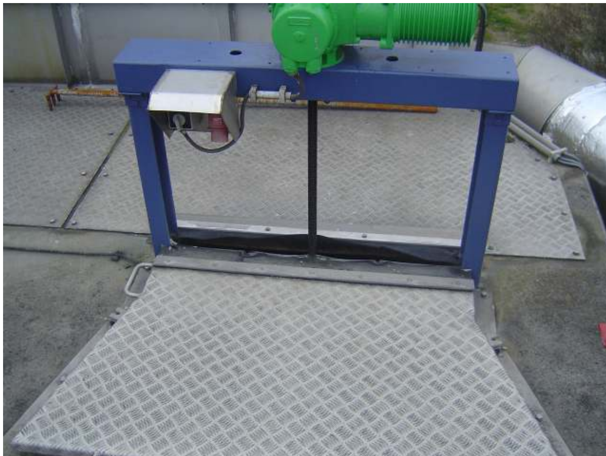
Zandvanger opening bovenzijde
