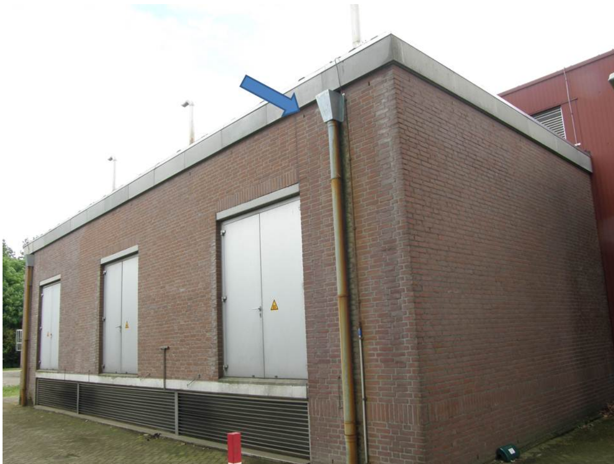
Figuur 2 Voorbeeld van een mogelijk vleermuisgeschikt gebouw. Holle spouwmuren met ventilatiegaten zijn in potentie geschikt, evenals ruimtes tussen daklijsten
