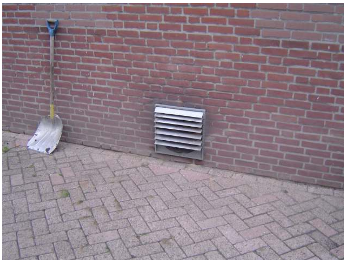
Machinegebouw afzuiging kelder
