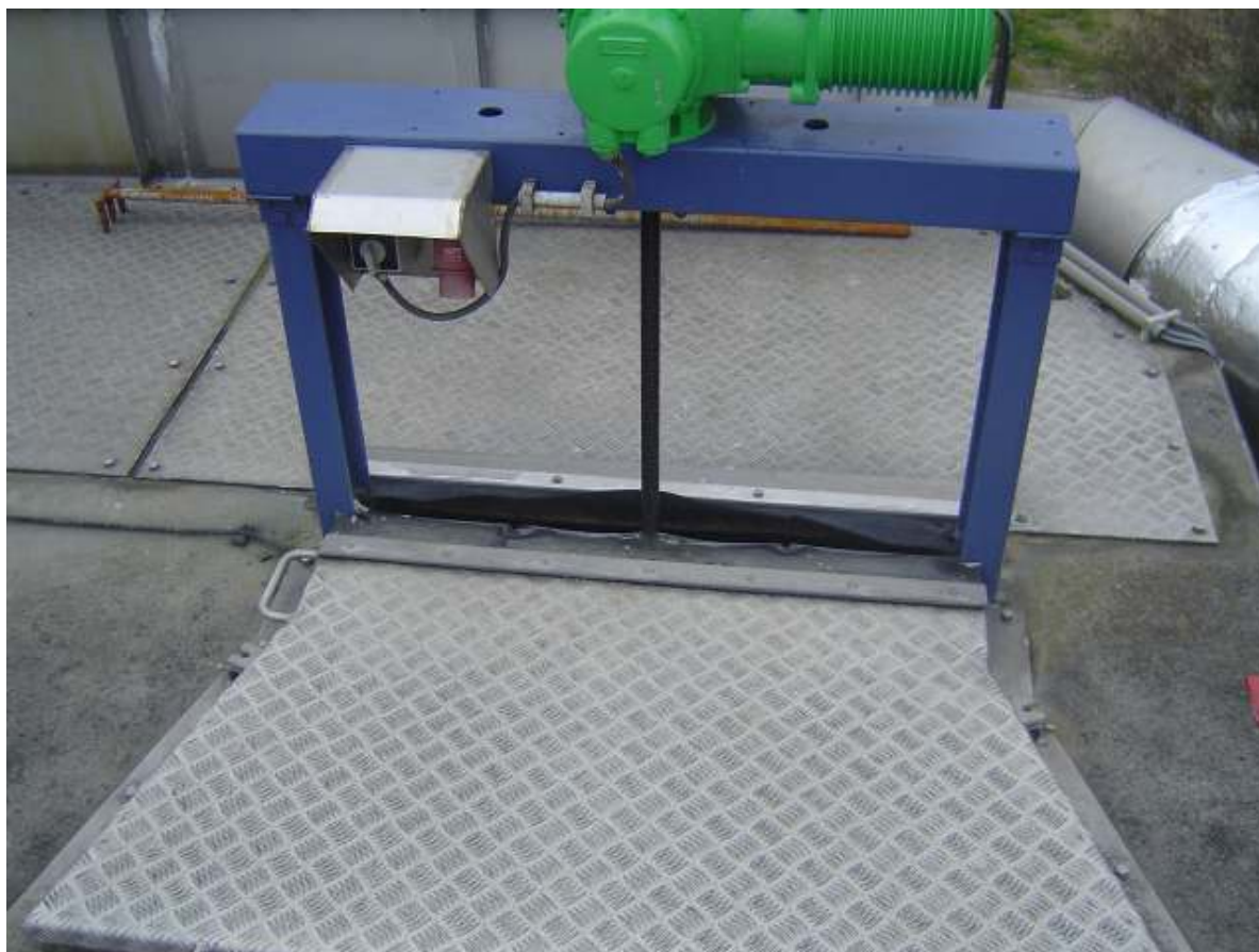
Zandvanger opening bovenzijde
