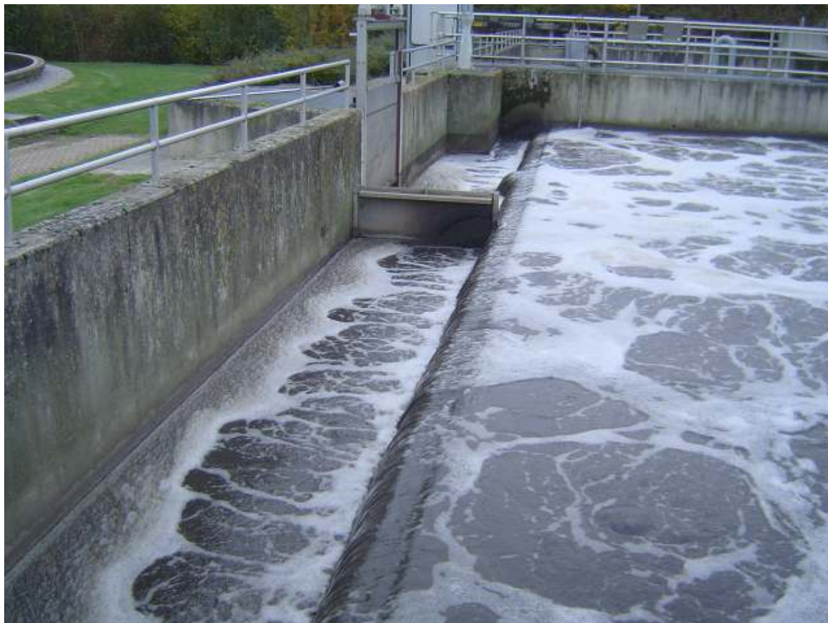
Beluchtingstank open gedeelte
