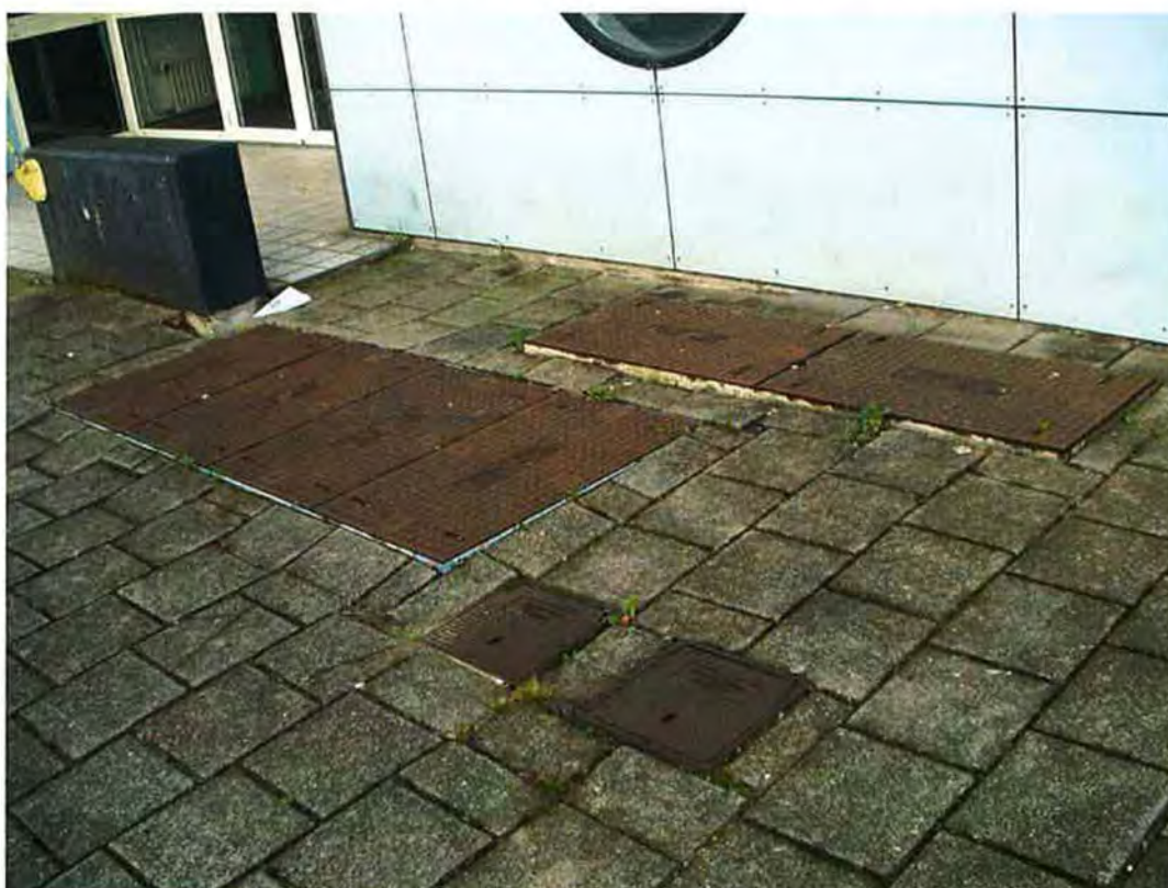
Metalen deksels in het trottoir voor Neherkade 1k, de voormalige locatie van de Keuringsdienst van waren
