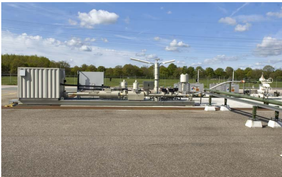
Winningsinstallatie, ter grootte van een kleine zeecontainer
