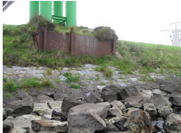
b) De bekleding is sterk overgroeid rondom de voet van de constructie. Dit wordt verwijderd voordat de overlaging wordt aangebracht.
