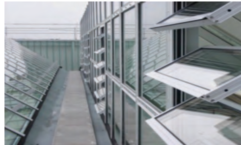
S.AIR , natuurlijke ventilatie in sheddaken
