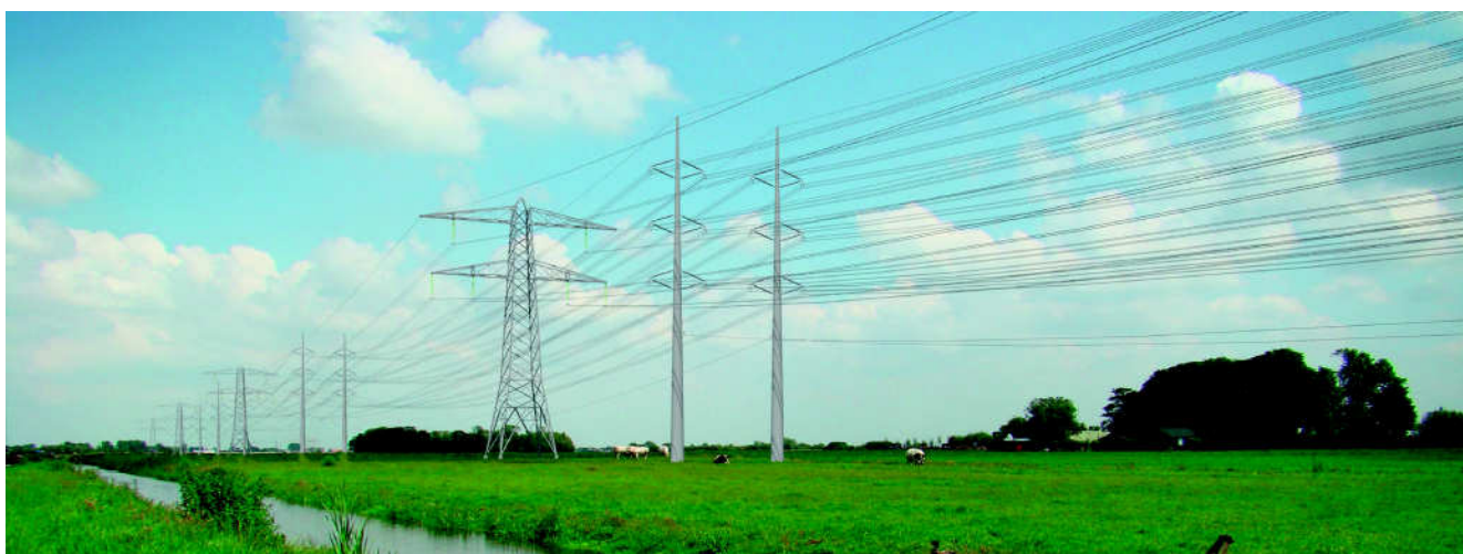
Afbeelding 4.5 Twee - circuits vakwerkmast gebundeld met vier - circuits Bipolemast
