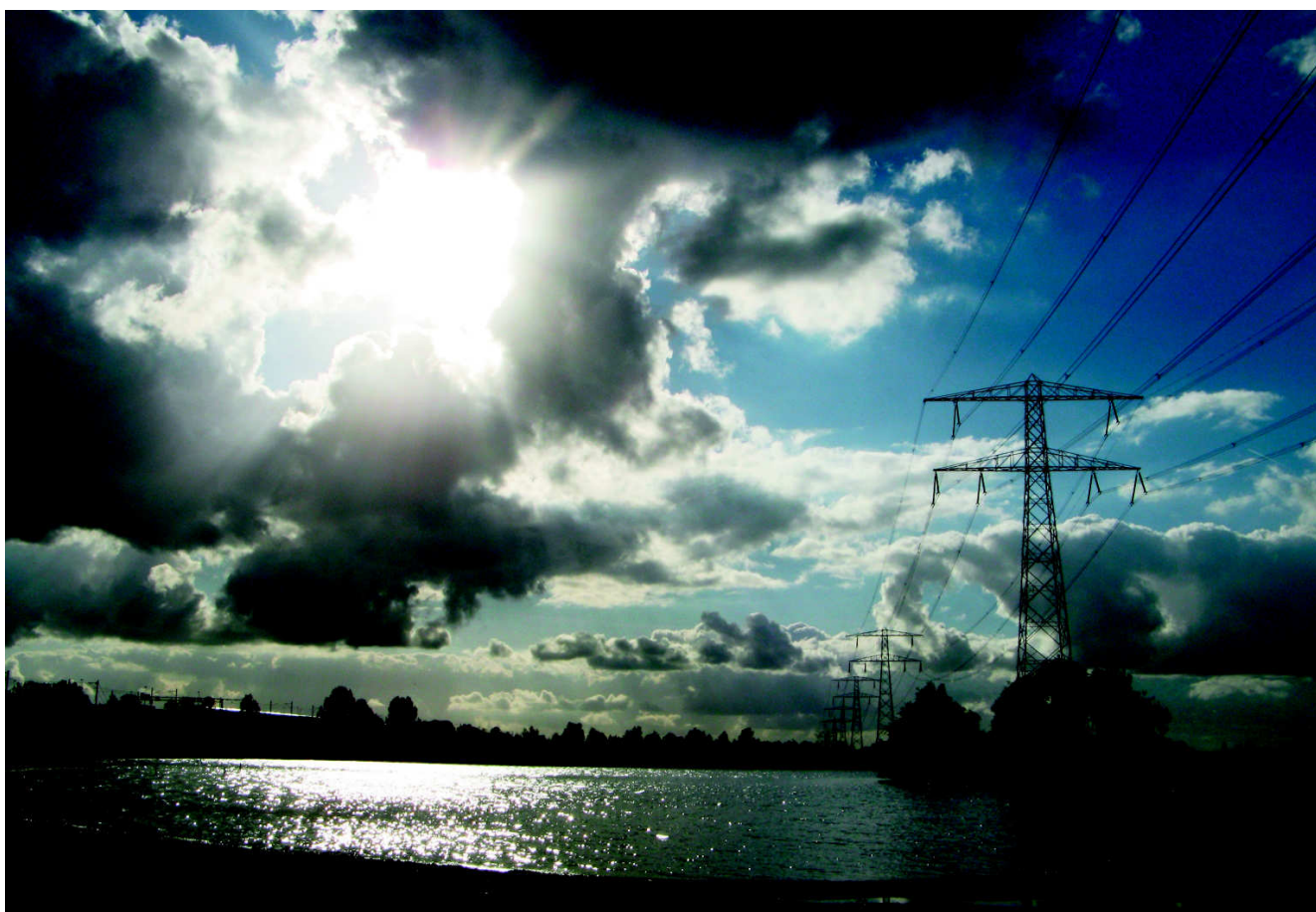
Afbeelding 5.2 De 380 kV verbinding bij Hollandse brug
