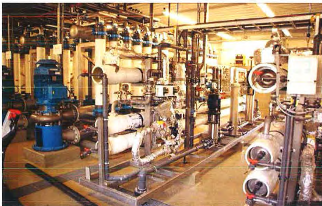
figuur 2 RO membraan installatie GWZI
