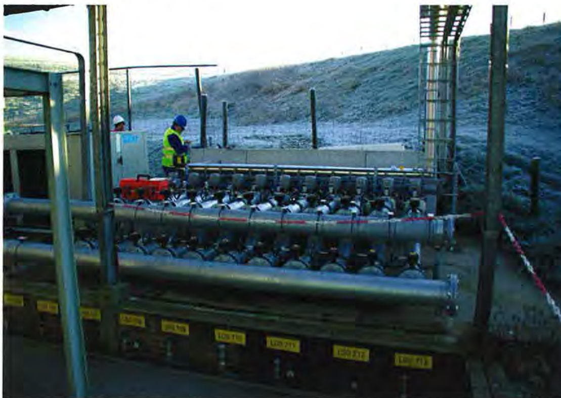
Figuur 3 onderstation manifold
