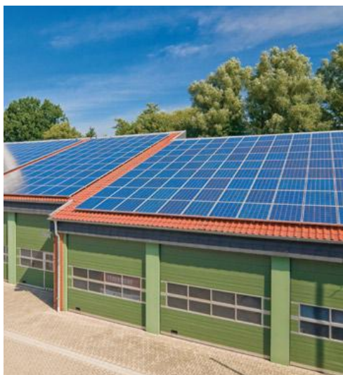
Foto 1. Voorbeeld van gemonteerde zonnepanelen.
