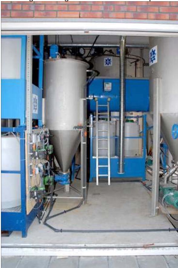
Figuur 2 Decentrale zuiveringsinstallatie in Sneek (bron: www.Oasen.nl )
