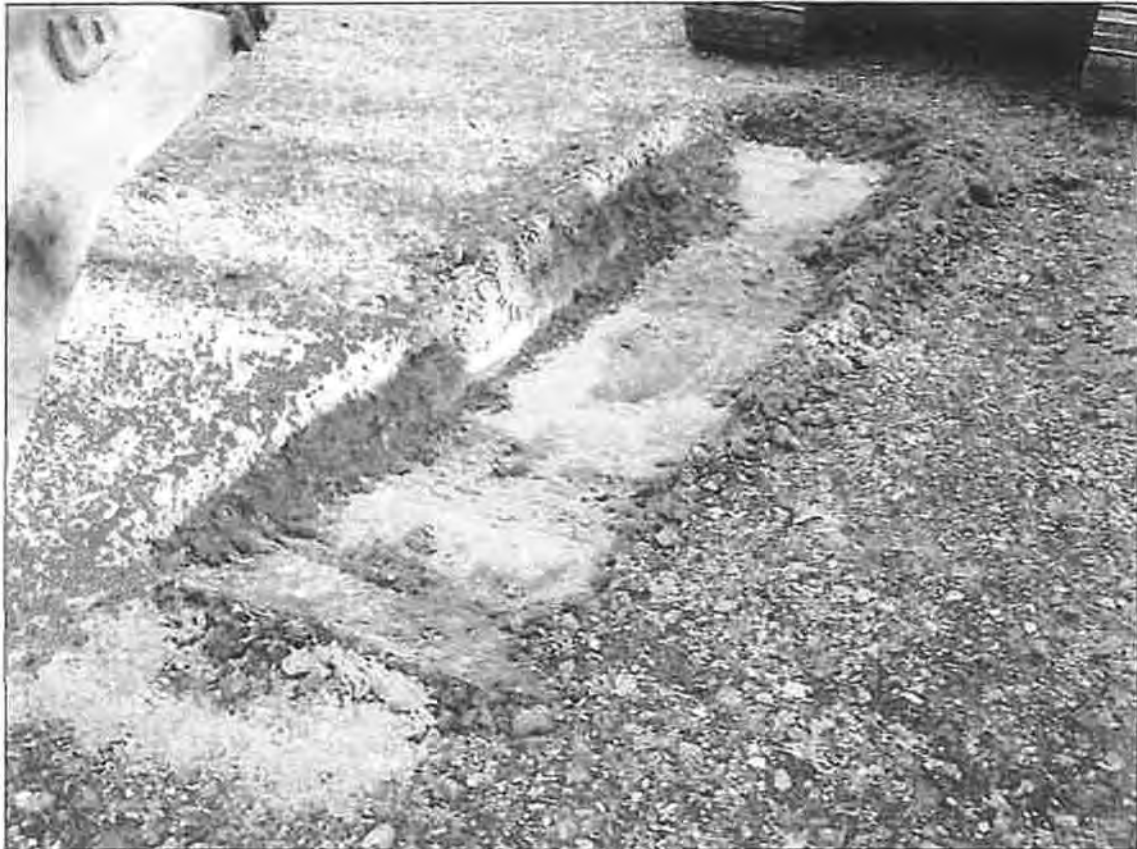
P2008-2426 Asbestonderzoek Overdiemenseweg te Diemen, Foto 3 (d.d. 7-10-2008)
