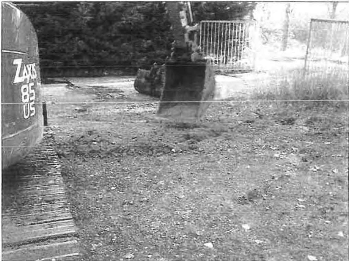
P2008-2426 Asbestonderzoek Overdiemenseweg te Diemen, Foto 1 (d.d. 7-10-2008)
