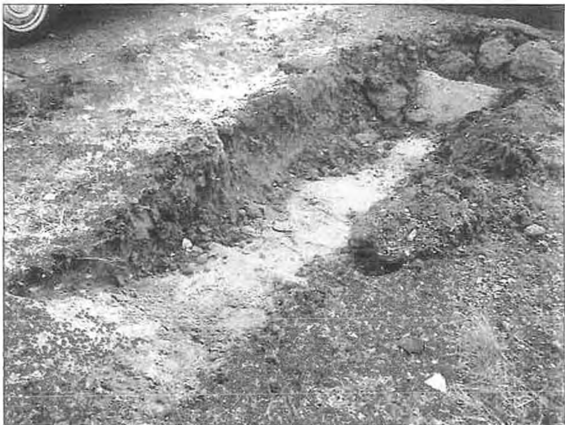
P2008-2426 Asbestonderzoek Overdiemenseweg te Diemen, Foto 2 (d.d. 7-10-2008)
