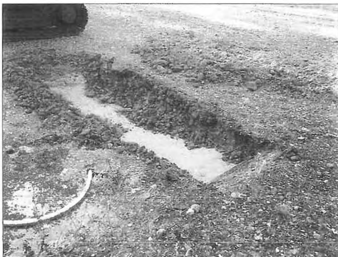
P2008-2426 Asbestonderzoek Overdiemenseweg te Diemen, Foto 6 (d.d. 7-10-2008)
