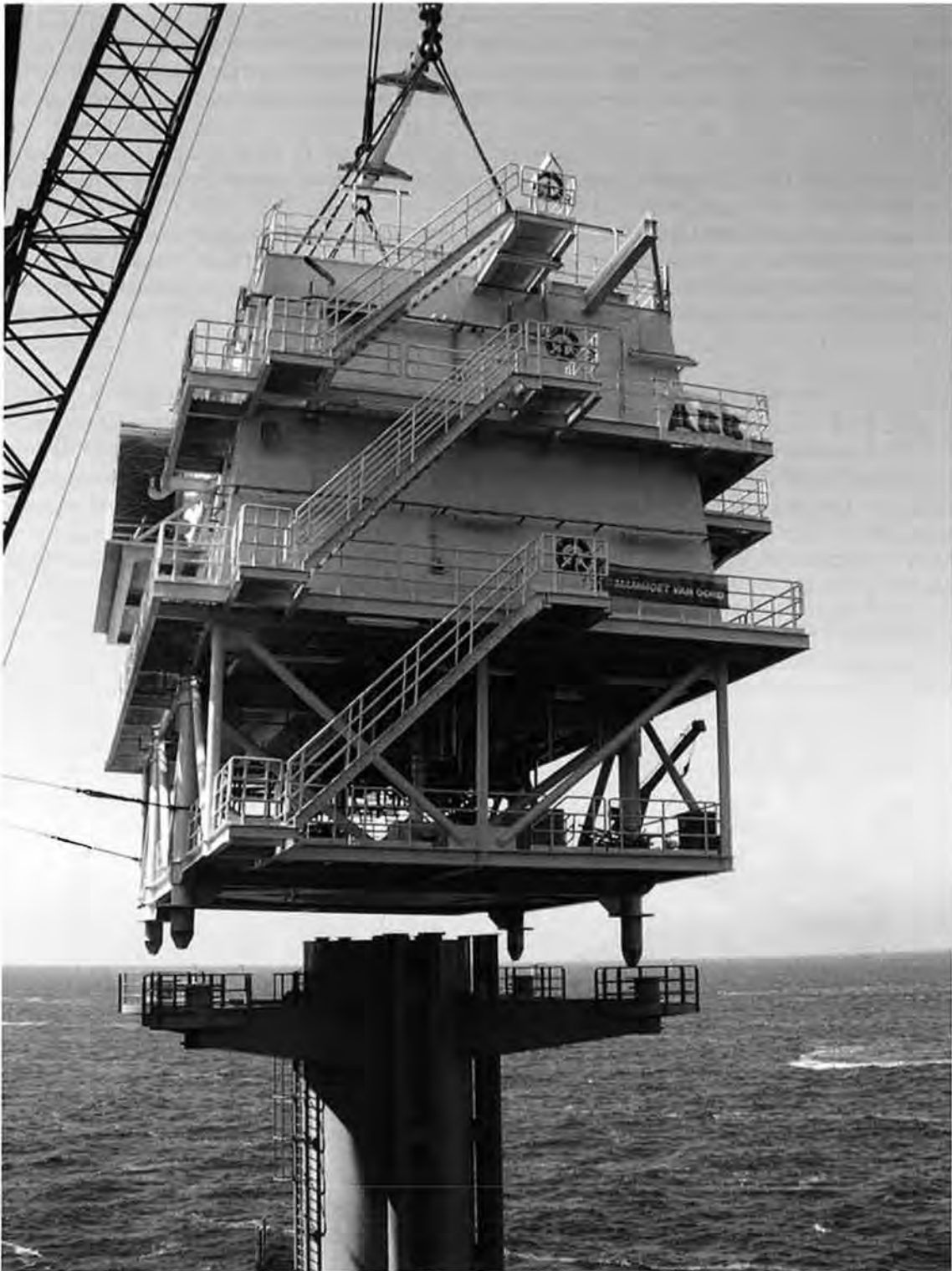
Afbeelding 3-5 Voorbeeld van een offshore transformatorstation (bron: Offshore windpark Prinses Amalia)
