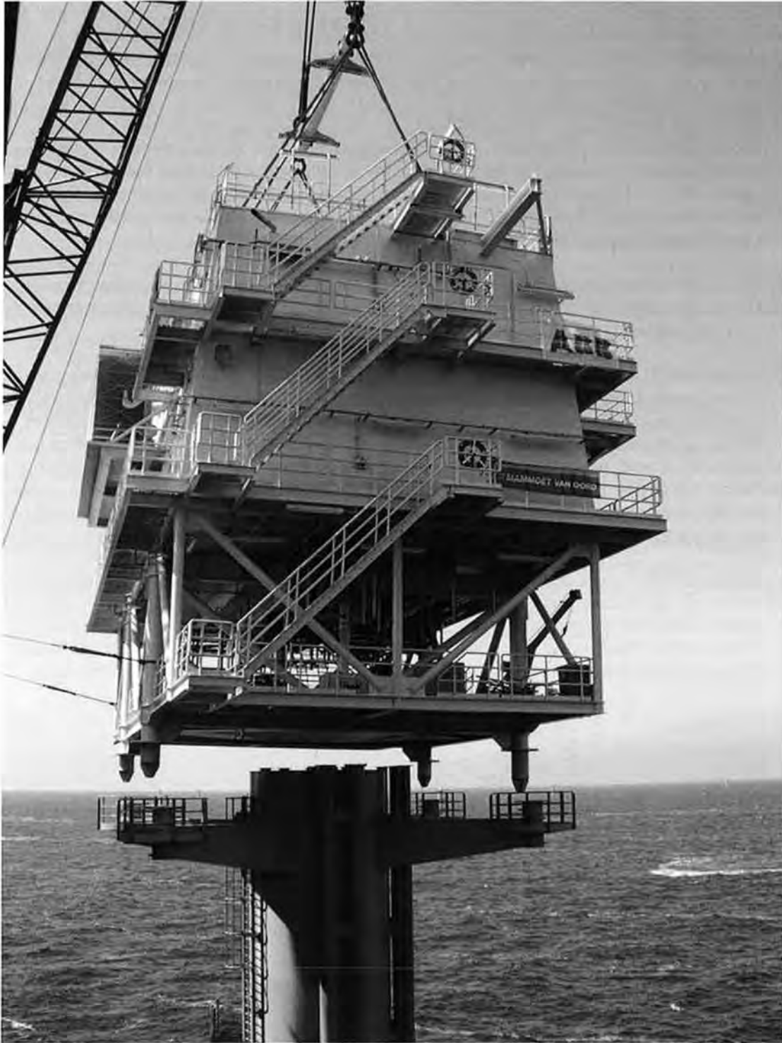
Afbeelding 3-3 Installatie transformatorstation (bron: windpark Prinses Amalia)
