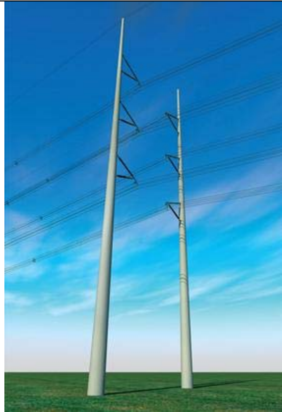
Figuur 6.1 380 kV mast
