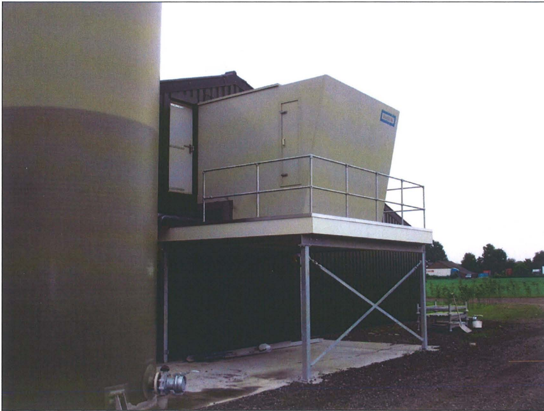
Figuur 21: gecombineerd luchtwassysteem
