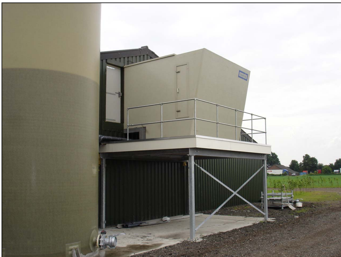
Figuur 15: gecombineerd luchtwassysteem
