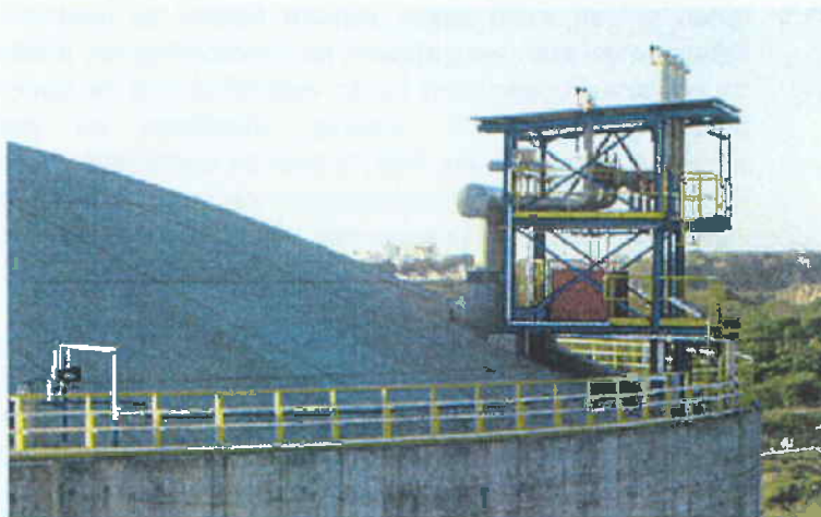
Figuur 4.9: PRV op een LNG-opslagtanks (Transgas Atlantico, Sines, Portugal).
