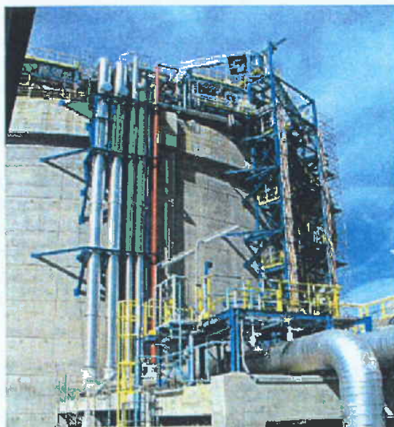
Figuur 4.10: Aansluitingen op de LNG-opslagtank gaan via het dak (Transgas Atlantico, Sines, Portugal).
