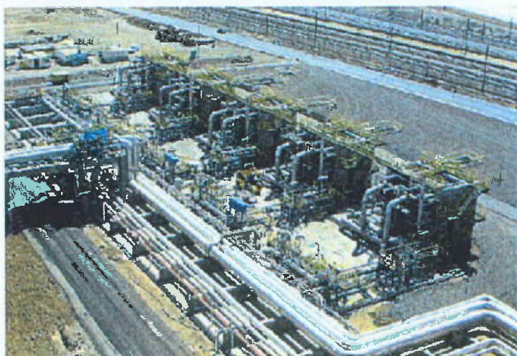
Figuur 4.12: Opstelling 'Open Rack Vaporizers' (Transgas Atlantico, Sines, Portugal).
