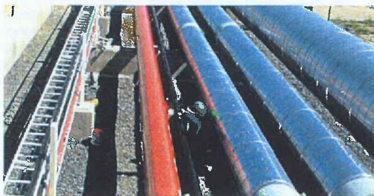
Figuur 4.11: RVS LNG transport- en recirculatieleidingen, RVS dampretourleiding en bluswaterleiding (rood) (Transgas Atlantico, Sines, Portugal).
