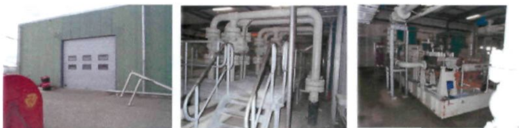
Figuur 5-2: Typische beelden van het pompgebouw
