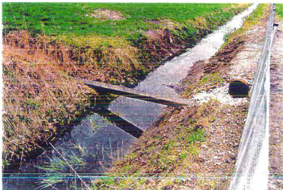
Dassentunnel onder de N618 (431) ter hoogte van de Geelders (knelpuntnr. 160).
