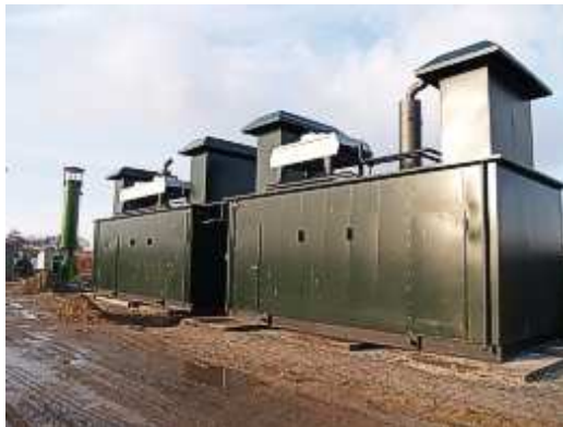
De containers met de gasmotoren. (4)
