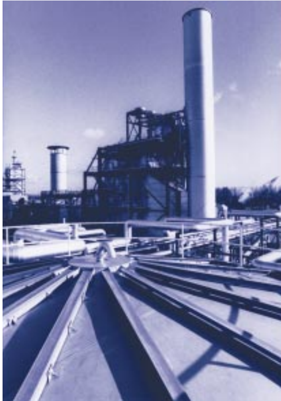
Gezamenlijke warmte-krachtinstallatie bij Eurogen: minder ruimtebeslag én beter voor het milieu.
