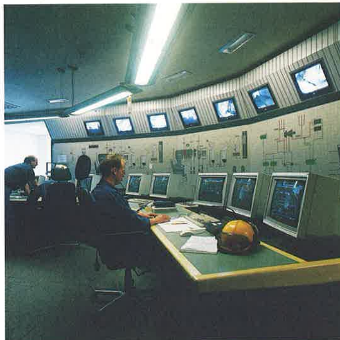
Centrale meet- en regelwacht.
