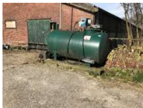
Figuur 22 brandstoftank asbestverdacht dak kleine schuur
