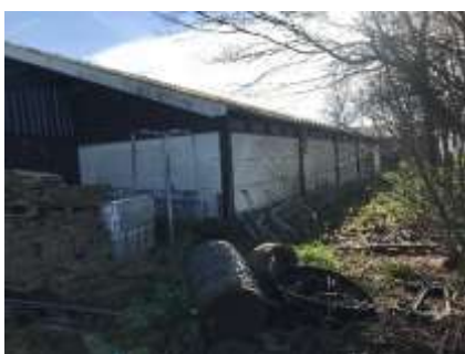
Figuur 17 Schuur met asbestverdacht dak
