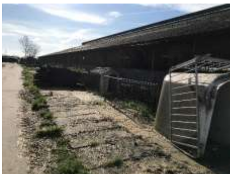
Figuur 21 asbestverdacht dak grote schuur en verharding
