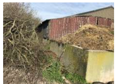
Figuur 23 asbestverdacht dak kleine schuur
